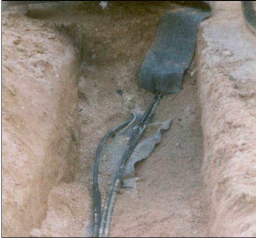
Die 1. 20 kV-Muffe von oben
