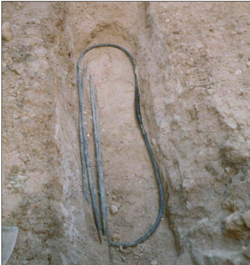
Die 2. 20 kV-Muffe von oben
