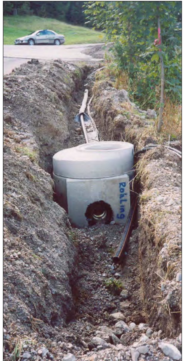
Der Abwassersammelschacht Rechenau.
